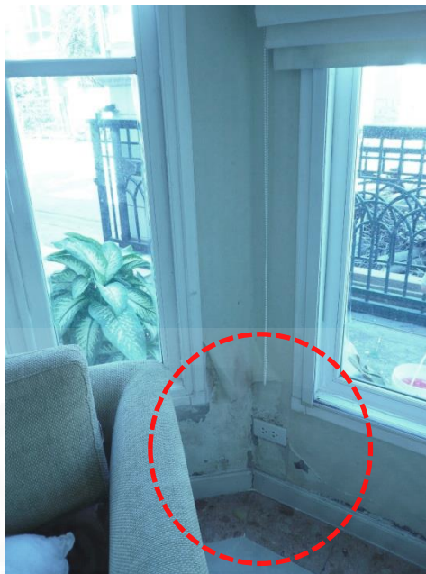
ภาพที่ 3.3 แสดงการร้าวซีมระหว่างผนังกับผนัง.
