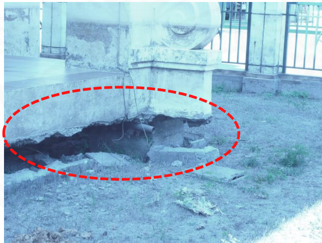
ภาพที่ 3.6 ภาพแสดงช่องว่างระหว่างพื้นดินกับตัวบ้าน.
