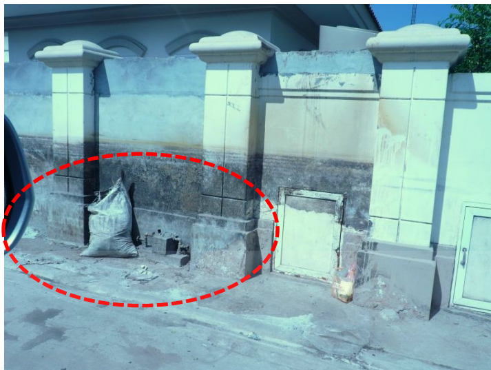
ภาพที่ 3.7 ภาพแสดงรอยน้ำจากกำแพงด้านนอกที่ได้รับการป้องกันแล้ว.
