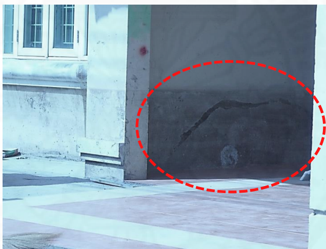
ภาพที่ 3.8 ภาพแสดงรอยน้ำที่เกิดตรงผนังบ้าน.
