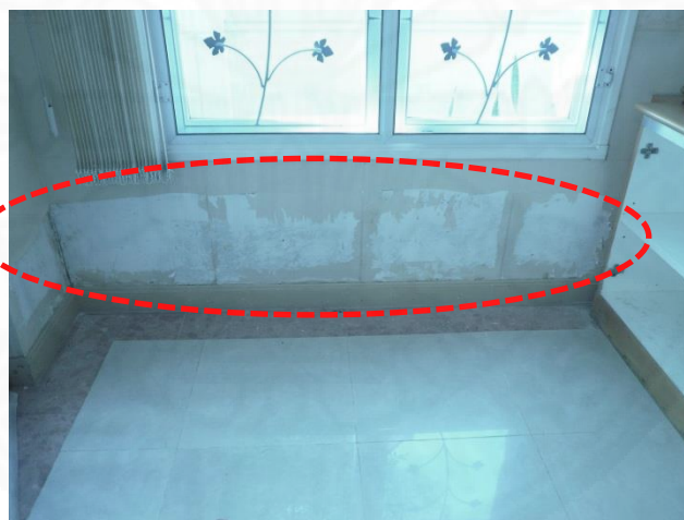
ภาพที่ 3.4 แสดงการร้าวซีมระหว่างผนังกับวงกลบนหน้าต่าง.
