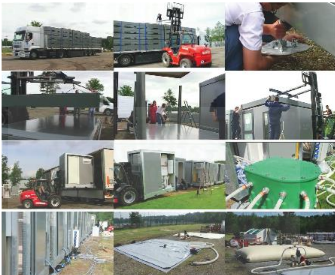
ภาพที่ 2.53 กระบวนการในการติดตั้งโรงแรมบิลโม. จาก abimo , 2008.
