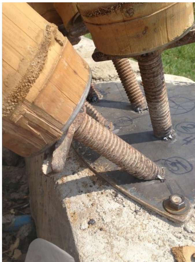
ภาพที่ 2.8 แสดงลักษณะของการต่อไม้ไผ่ในแบบใช้คอนกรีตและเหล็ก. ภาพถ่ายโดยผู้เขียน, ถ่ายภาพเมื่อวันที่ 10 พฤษภาคม 2556
