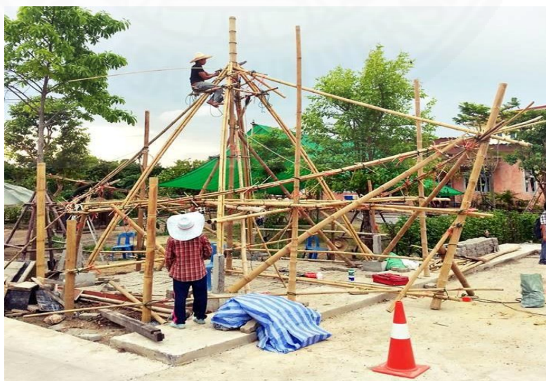
ภาพที่ 4.10 การตั้งเสาไม้ไผ่เพื่อดูความสูงและเค้าโครงอาคาร
