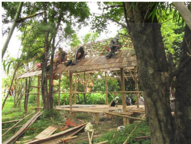
ภาพที่ 1.1 การก่อสร้างบ้านไม้ไผ่ของระบบการก่อสร้างแบบในที่ (On-site Construction)
