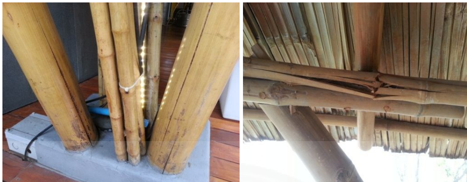
ภาพที่ 4.45 การแตกร้าวของโครงสร้างอาคารที่เกิดจากตัววัสดุ หมายเหตุ. ถ่ายโดยผู้วิจัย, 5 ธันวาคม 2557.
