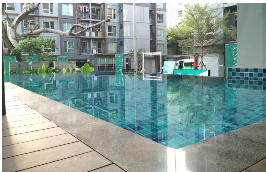
ภาพที่ 4.12 สระว่ายน้ำระบบเกลือ
