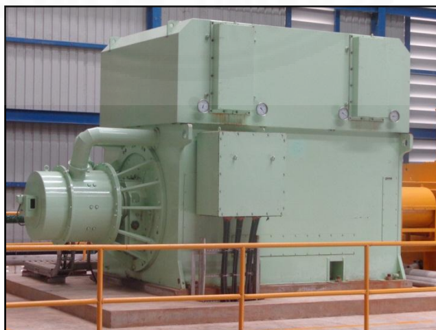
17. เครื่องกำเนิดไฟฟ้า (Generator)
