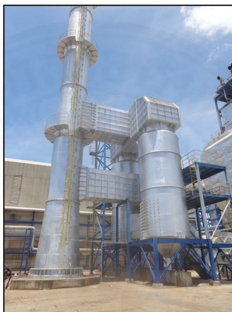
14. ระบบจับฝุ่นโดยใช้ม่านน้ำจับ (Wet Scrubber)
