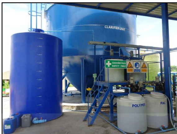
1. ถังตกตะกอน (Clarifier)
