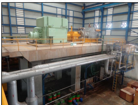
ที่ตั้งส่วนประกอบ 15. เครื่องกังหันไอน้ำ (Steam turbine) 16. ชุดเกียร์ทด (Gearbox) และ 17 .เครื่องกำเนิดไฟฟ้า (Generator)
