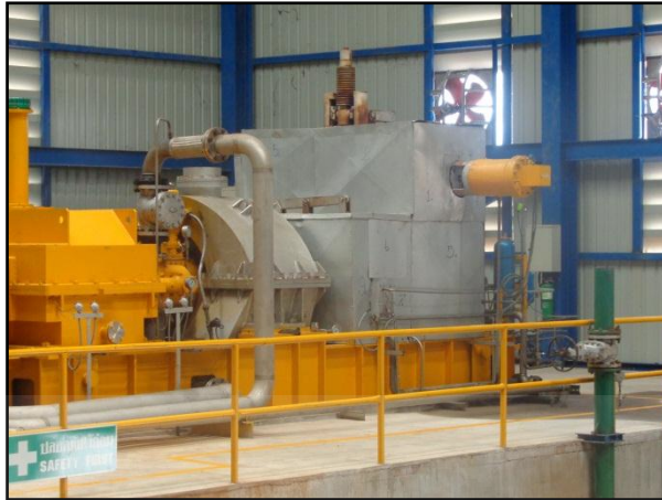
15. เครื่องกังหันไอน้ำ (Steam turbine)
