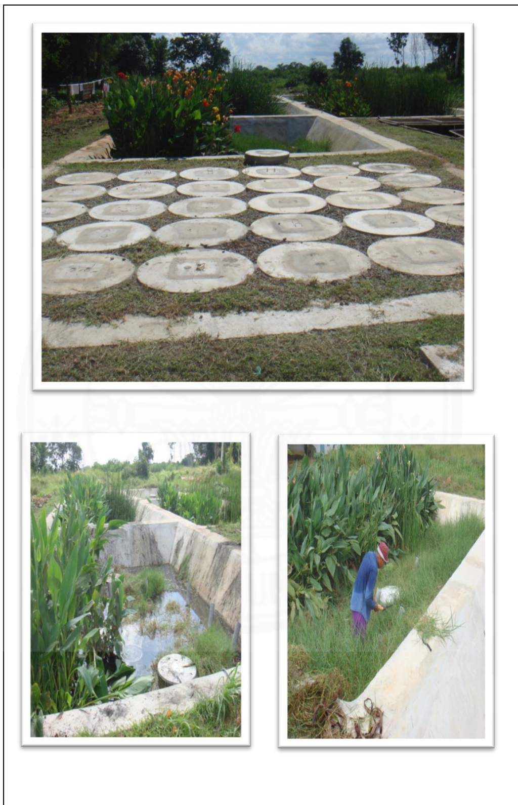
ภาพที่ 4.3 ระบบบำบัดน้ำเสียแบบถังกรองไร้อากาศร่วมกับการบำบัดด้วยดินและปืงประดิษฐ์
