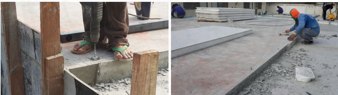
ภาพที่ 4.42 การเจาะพื้น และฝังฟูก เพื่อใช้ในการติดตั้งรางเหล็ก
