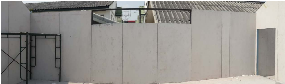
ภาพที่ 4.49 แผ่นผนังฉนวนโครงสร้างที่ติดตั้งแล้ว
