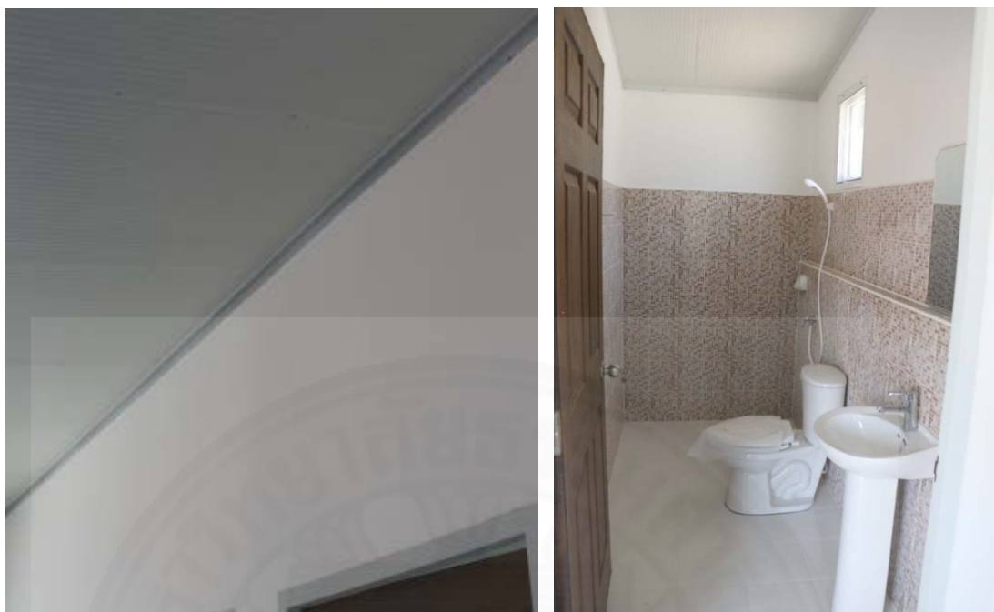
ภาพที่ 4.61 รอยต่อระหว่างผนังของอาคารกับแผ่นหลังคา และการปูกระเบื้องห้องน้ำ
