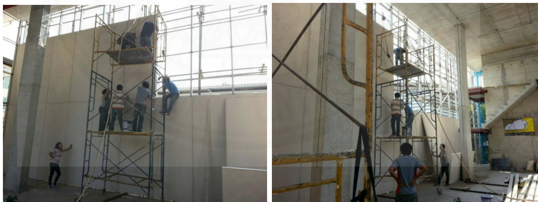
ภาพที่ 4.13 การติดตั้งแผ่นฉนวนโครงสร้างของอาคารกรณีศึกษาที่ 1, จาก บริษัท A, 2558
