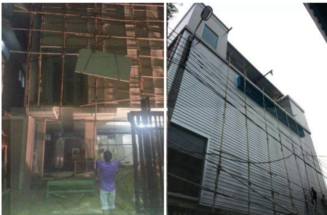
ภาพที่ 4.14 การขนส่งแผ่นฉนวนโครงสร้างในแนวดิ่ง ด้วยรถยกไฟฟ้า , จาก บริษัท A, 2558
