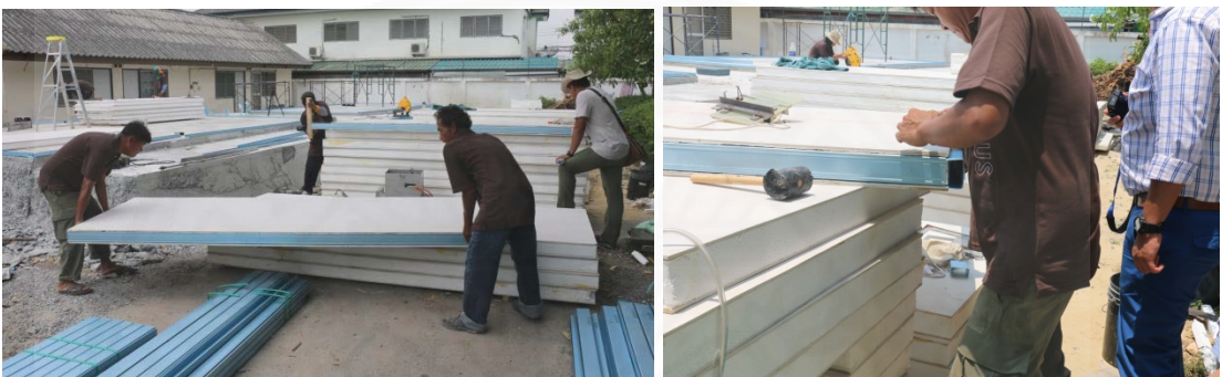
ภาพที่ 4.41 การเตรียมชิ้นส่วนโดยการติดตั้งเหล็กยึดยื่นด้านข้างแผ่นผนัง
