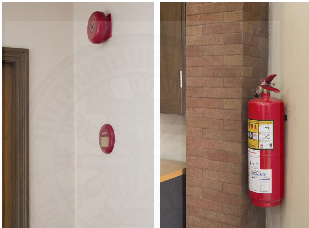
ภาพที่ 4.10 ระบบความปลอดภัยด้านอัคคีภัยภายในโรงแรม A
