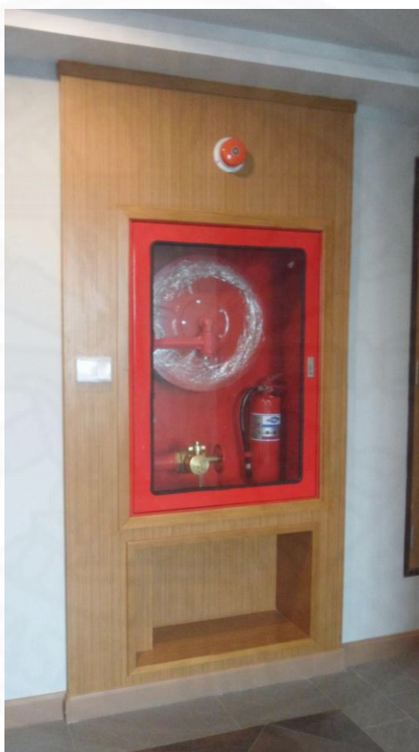
ภาพที่ 4.27 ระบบความปลอดภัยด้านอัคคีภัยภายในโรงแรม C
