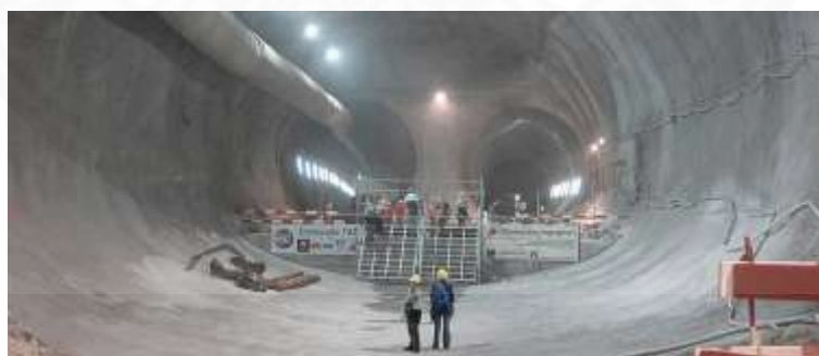
ภาพที่ 2.3 การก่อโครงและฉีดพ่นคอนกรีตเพื่อสร้างผนังอาคาร. จาก http://www.novocon.co.nz/images/products/shotcrete3.jpg , 2012
