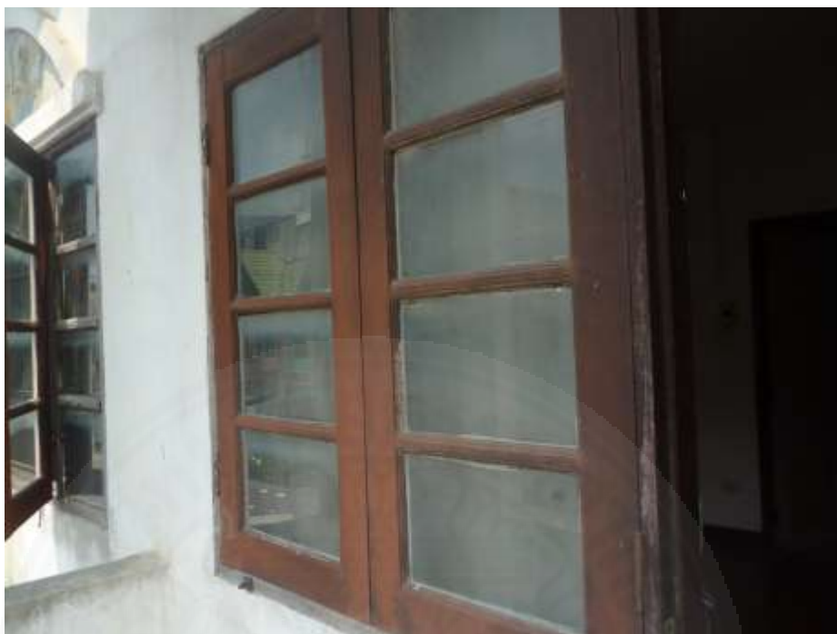
ภาพที่ 4.8 ลักษณะตัวอย่างหน้าต่างบานกระจกกรอบไม้
