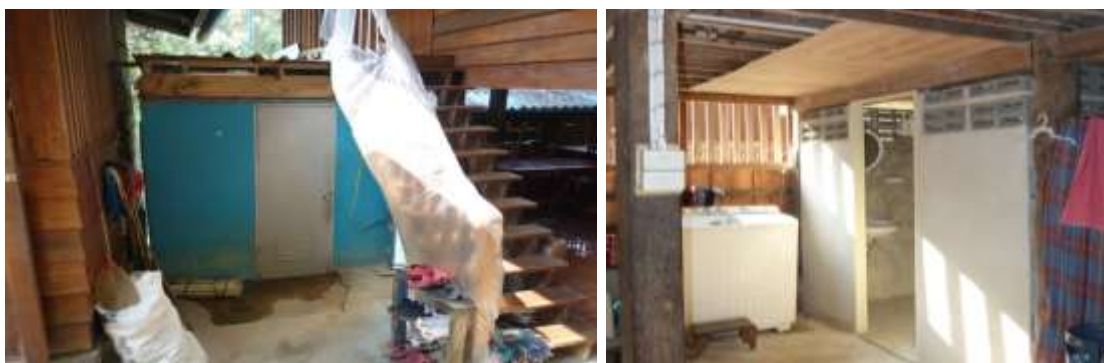
ภาพที่ ก.27 ห้องน้ำเพิ่มแบบแยกหลัง TH-H1 (ชาย) และแบบต่อเติมที่ใต้ถุนบ้าน TH-H13 (ขวา).
