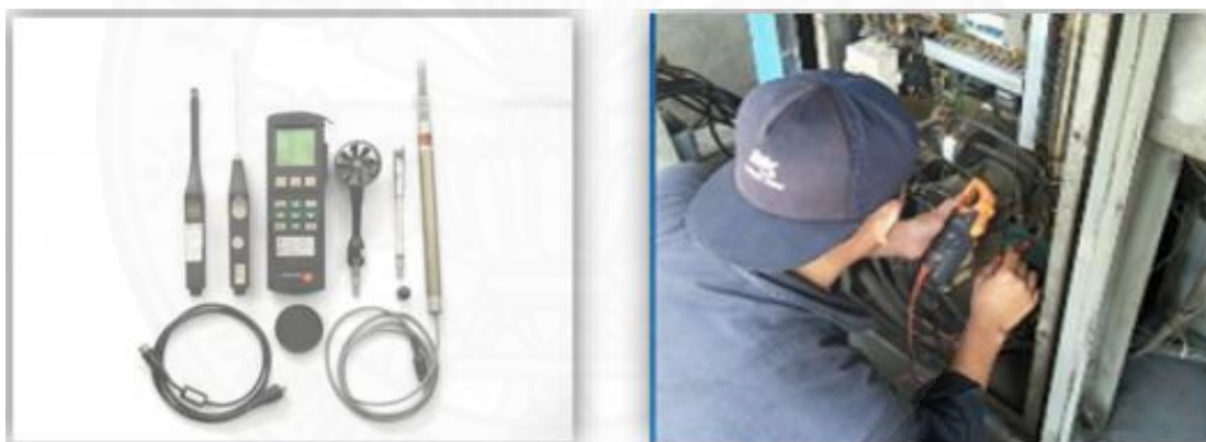
ภาพที่ 3.6 การตรวจวิเคราะห์ด้านประสิทธิภาพพลังงานเครื่องอัดอากาศ ของบริษัท TODA PIPE THAILAND CO., LTD
