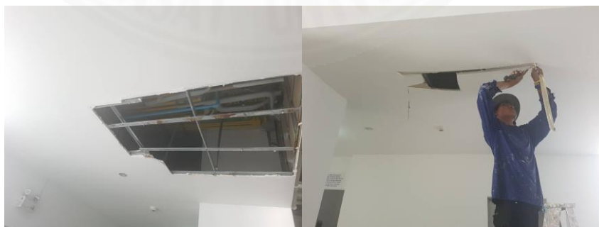
ภาพที่ 4.3 แสดงการซ่อมแซมที่ผิดจุด เนื่องมาจากแบบก่อสร้างจริงมีระยะไม่ตรงตามหน้างาน
