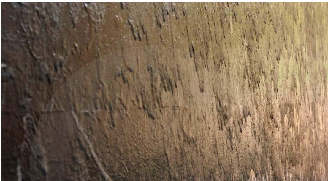
ภาพที่ 4.16 ลักษณะการไหลของน้ำส่วนทางเดินเชื่อมจากอาคารต้อนรับสู่อาคารที่พักโครงการวีร์นดา เชียงใหม่ เดอะไฮท์ รีสอร์ท. โดย ผู้วิจัย, 2560.
