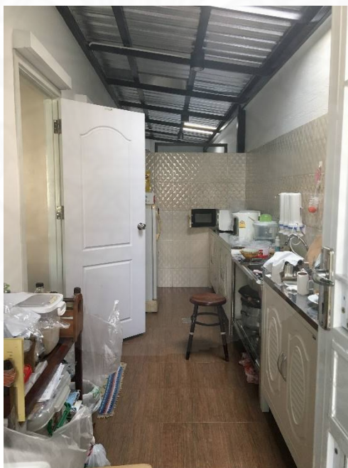
ภาพที่ 4.13 ครัวหลังบ้านที่ถูกต่อเติมแต่ไม่ได้มีการกันผนังจนสูงถึงหลังคา
