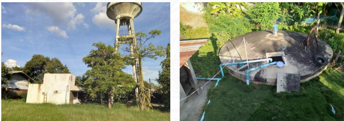
ภาพที่ 3.5 ระบบหอถังสูงและระบบถังน้ำใสประปาหมู่ที่ 5 ที่มา: การสำรวจระบบประปาหมู่ที่ 5 บ้านใหม่เกษมใต้
