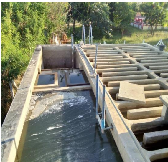
ระบบกรองน้ำประปา
