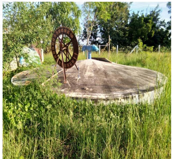
ถังกักเก็บน้ำประปา
