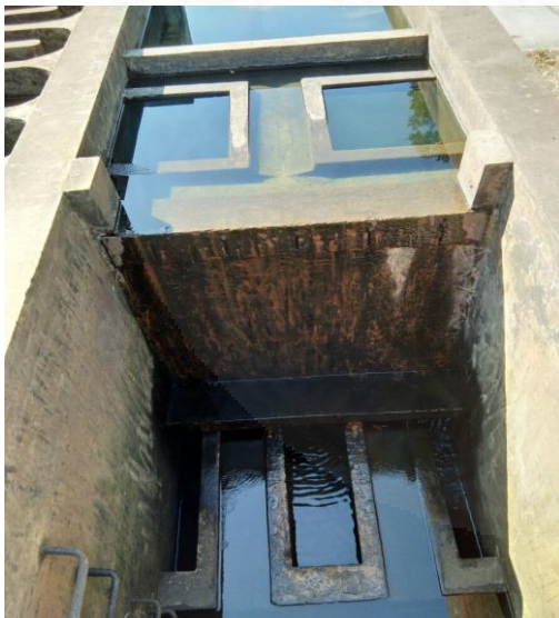
ระบบกรองน้ำประปา
