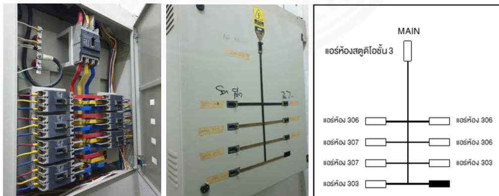
ภาพที่ 3.12 เมนเซอร์กิต เบรกเกอร์ ไฟฟ้าสามเฟสของระบบปรับอากาศ
