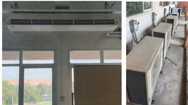
ภาพที่ 3.11 ระบบปรับอากาศห้องเรียนสตูดิโอ
