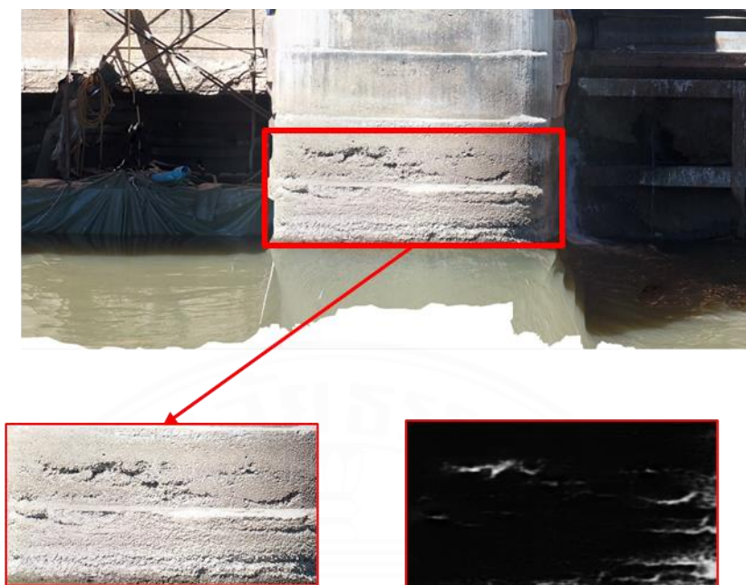
ภาพที่ 4.7 รอยแตกร้าวที่น่าสนใจ จุดที่เข้าถึงได้ยากและเป็นพื้นที่จำกัด บริเวณ ตอม่อ ส่วนควบคุมน้ำ อาคารประตูระบายน้ำพลเทพ
