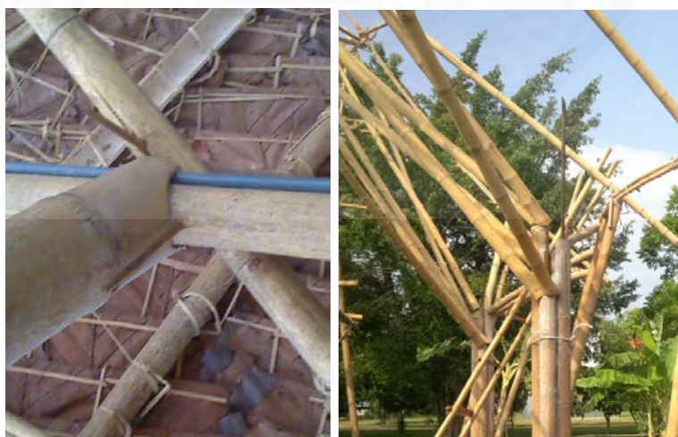
ภาพที่ 5.19 การบากไฟเพื่อการเชื่อมต่อสำหรับโครงสร้างไม้ไฟ
